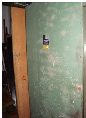
Foto 43 – Esquadria deteriorada Fonte: CL Engenharia e Urbanismo
