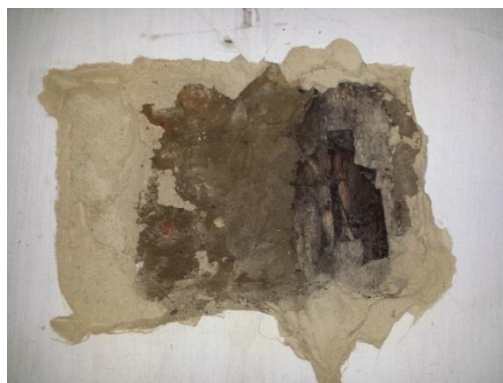
Foto 17 Observar detalhes dos estrados, pintura, reboco, barro de taipa e esteio em avançado estado de decomposição Fonte: CL Engenharia e Urbanismo
