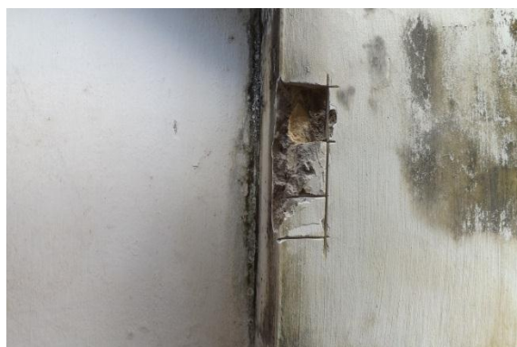
Foto 27 Reboco muito resistente à quebra. Fonte: CL Engenharia e Urbanismo
