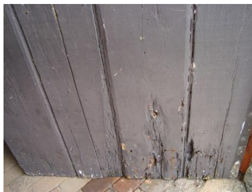
Foto 35 – Esquadria Deteriorada Fonte: CL Engenharia e Urbanismo.
