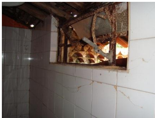
Foto 45 – Esquadria deteriorada Fonte: CL Engenharia e Urbanismo.
