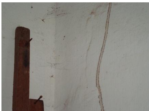
Foto 38 – Elementos espúrios e sujidade na Parede Fonte: CL Engenharia e Urbanismo
