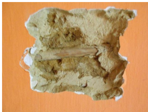
Foto 15 – Detalhe da alvenaria de taipa. Observar reboco e parte da trama em madeira Fonte: CL Engenharia e Urbanismo
