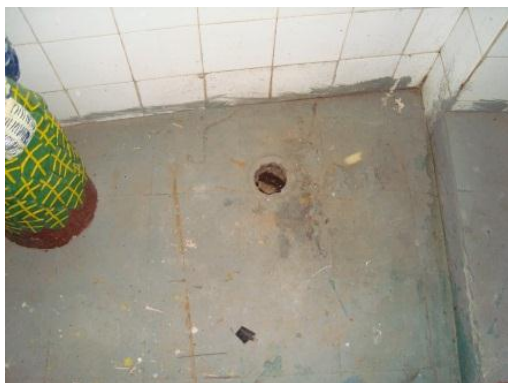
Foto 42 – Desgaste do revestimento | sujeira no piso Fonte: CL Engenharia e Urbanismo
