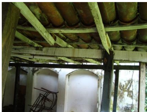
Foto 47 – Estrutura da cobertura deteriorada Fonte: CL Engenharia e Urbanismo.
