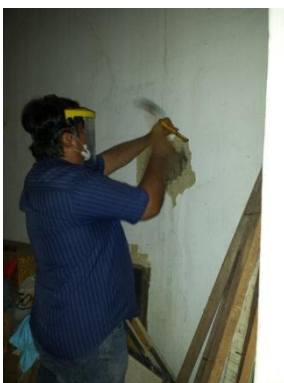
Foto 16 – Início da prospecção na alvenaria no trecho da circulação Fonte: CL Engenharia e Urbanismo
