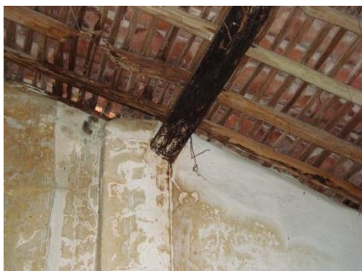
Foto 40 – Deterioração da Coberta da Copa| Umidade na Parede Fonte: CL Engenharia e Urbanismo
