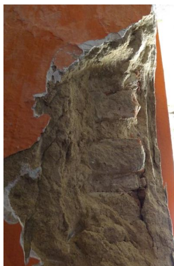
Figura 6 – Alvenaria frontal, imagem dos tijolos e argamassa de assentamento e reboco. Fonte: CL Engenharia e Urbanismo.
