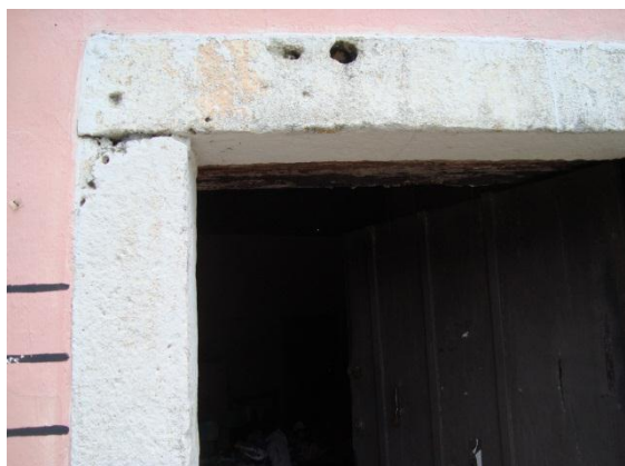
Figura 21 – Detalhes de danos na cantaria que devem ser obturados. Fonte: CL Engenharia e Urbanismo.
