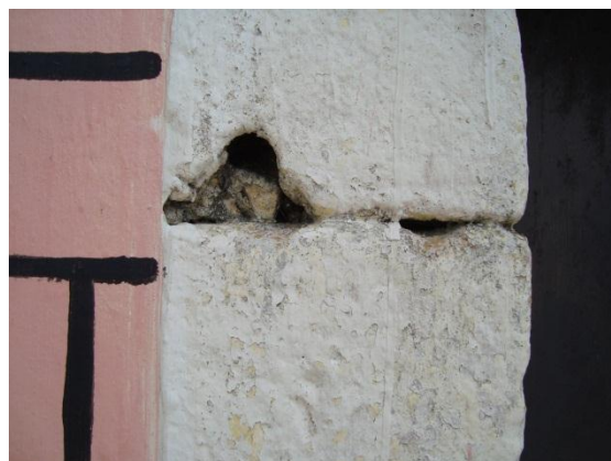
Figura 22 – Idem foto anterior. Fonte: CL Engenharia e Urbanismo.
