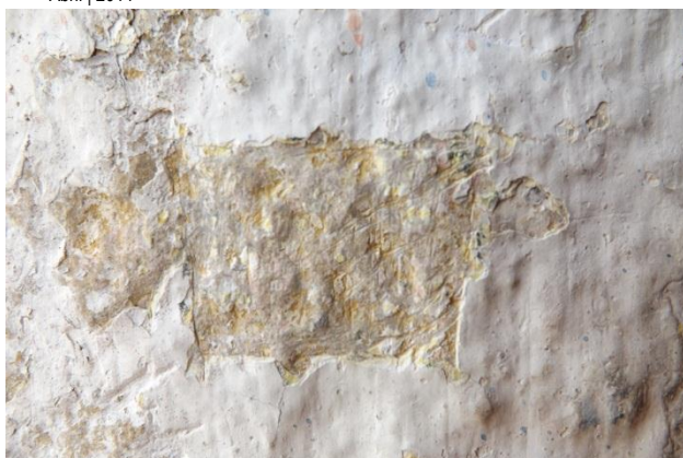
Figura 23 – Camadas de repintura sobre a cantaria da ombreira da porta.
