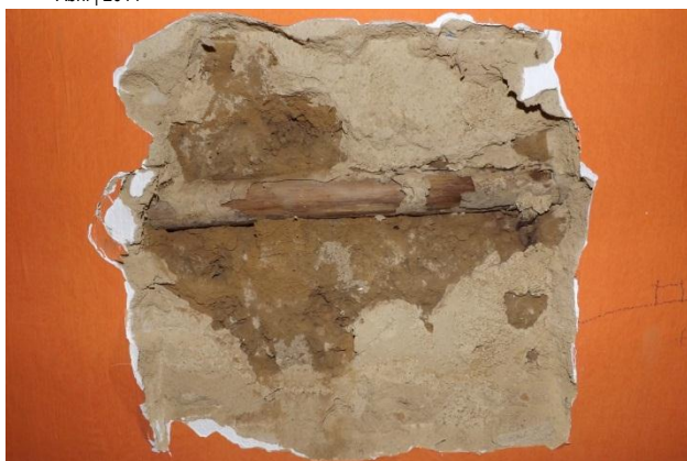
Figura 7 – Alvenaria de taipa. Argamassa mais escura é da alvenaria e a mais clara corresponde ao reboco. Fonte: CL Engenharia e Urbanismo.
