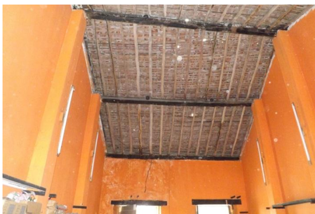
Figura 11– Vista da face inferior da cobertura. Linhas mais escuras pelo provável uso de bioxênio. Fonte: CL Engenharia e Urbanismo.
