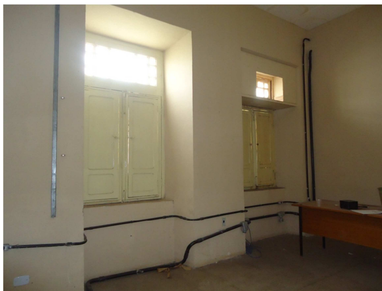
Figura 5 – Dutos de eletricidade aparentes
