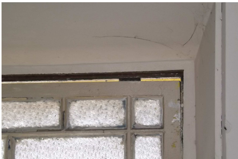
Figura 6 – Bandeira com dobradiças (intervenção descaracterizadora realizada para instalação de ar condicionado)
