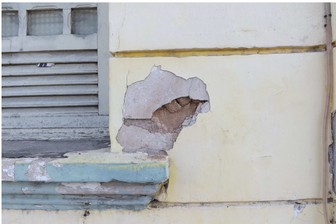
Figura 4 – Descolamento de reboco na Fachada Principal do Paço Municipal
