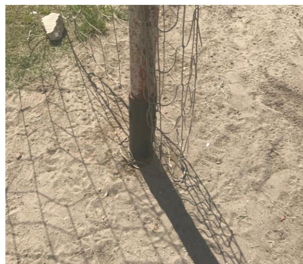
Figura 8: Desgaste da Barra existente
