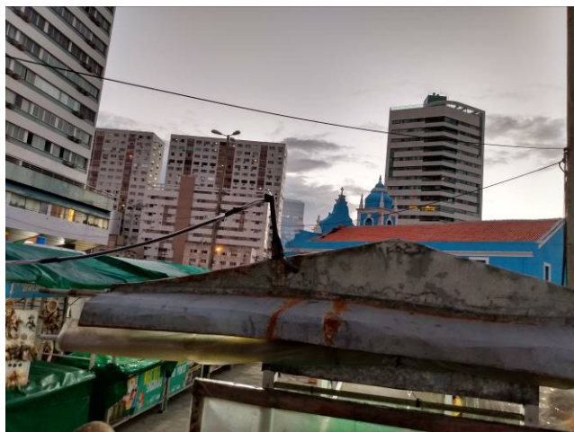
Figura 11 – Instalação elétrica fora do padrão. Fonte: Colméia, 2019.
