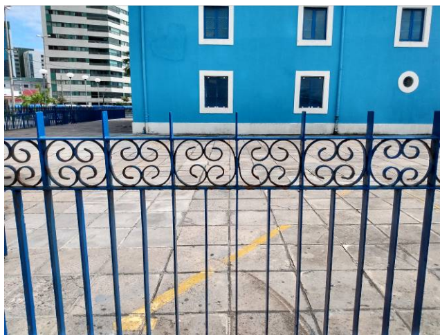
Figura 7 – Gradil na lateral da Igrejinha. Trechos com oxidação. Fonte: Colméia, 2019.
