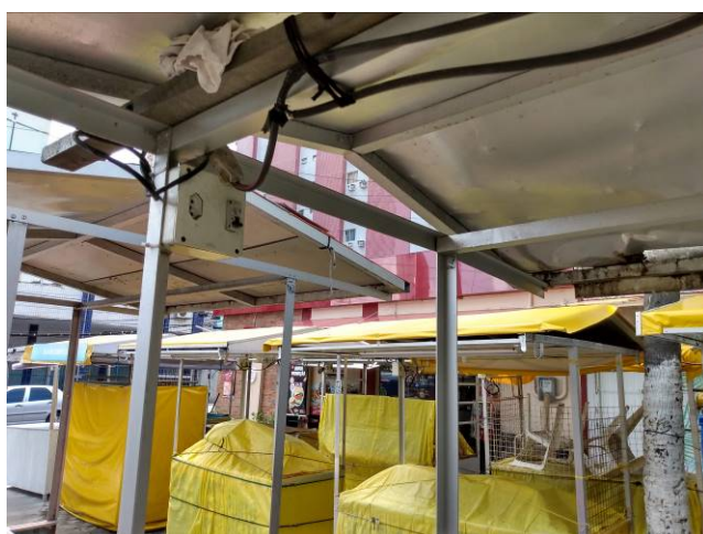
Figura 12 – Instalação elétrica fora do padrão. Fonte: Colméia, 2019.
