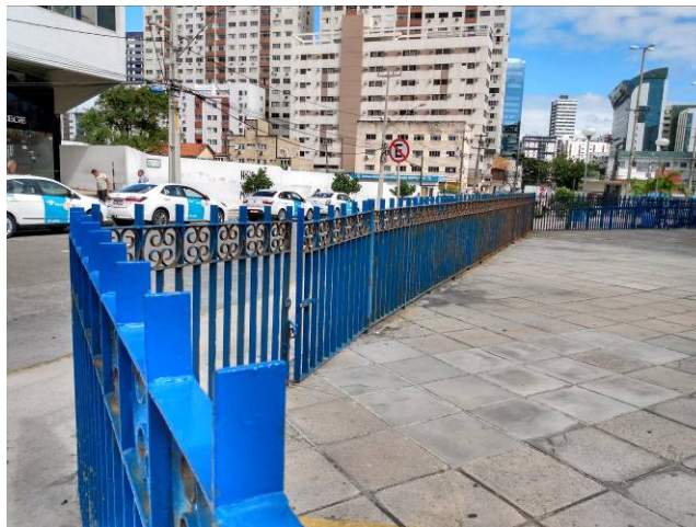
Figura 6 – Gradil em frente a Igrejinha. Trechos com oxidação. Fonte: Colméia, 2019.
