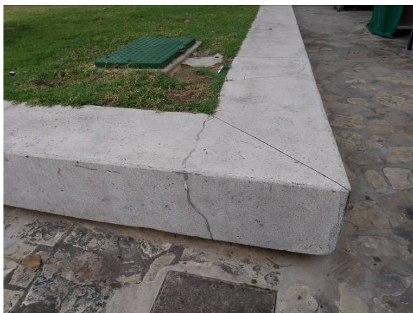
Figura 2 – Rachaduras e reparos anteriores feitos no revestimento de granilite do banco. Fonte: Colméia, 2019.
