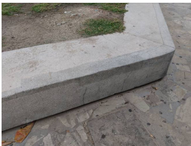
Figura 3 – Emenda feita no revestimento de granilite do banco. Fonte: Colméia, 2019.
