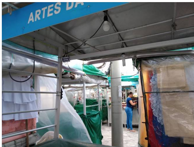
Figura 10 – Instalação de iluminação fora do padrão. Fonte: Colméia, 2019.
